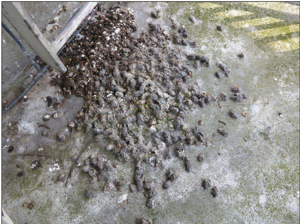
Onder aan de trap van het onderste plateau op de radartoren zijn een grote hoeveelheid braakballen en ontlasting aangetroffen.
